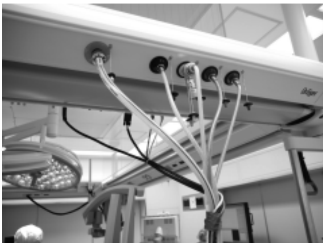
図2 ビーム上の医療用ガスと電源、生体モニタのアウトレット
