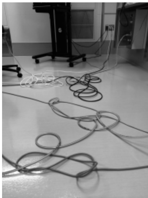
図5 手術室の床上をはう電線と配管 手術室で使う医療用機器の配線・配管は主に手術室壁面のアウトレットから行うため、電線やガス管が床をはい、大型機器・人の移動と清掃の妨げとなる。しかし、手術室の床上の配線・配管を排除する試みは、ほとんど行われていない
