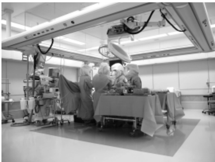
図6 オペラ手術室の床面 床面をはう電線や配管がない。オペラ直下の床面は色分けによって、清潔野と不潔野に区別されている
