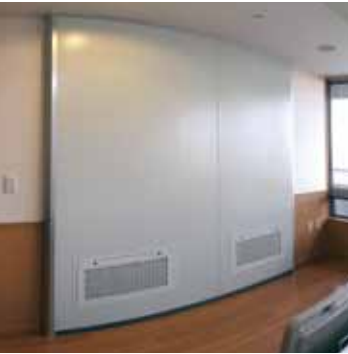
壁面のダクトパネル
